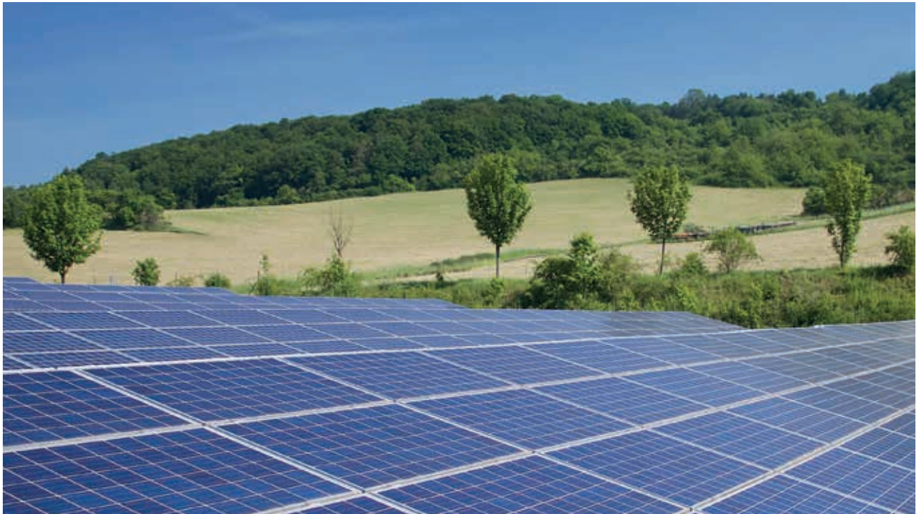
Freiland-Photovoltaik-Anlage am Hauptsitz in Treffurt
