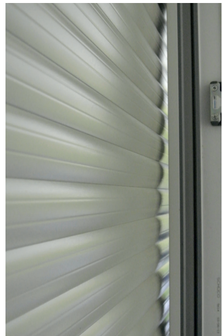
Abbildung 30: Panzer, der „ausbaucht“. Die Rollladenstäbe wölben sich nach vorne.
