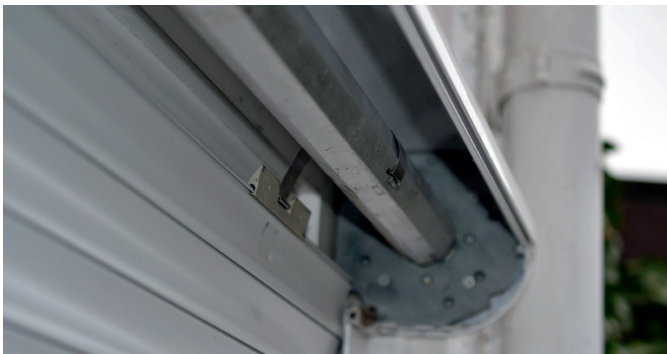
Abbildung 26: Auf den obersten Stäben sind Abdrücke der Aufhängefedern zu erkennen. Diese Abdrücke sind kaum zu vermeiden und in diesem Umfang zulässig.
