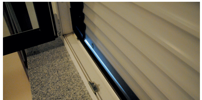
Abbildung 15: Geringfügiger indirekter Lichteinfall über die Fensterbank. Die Ursache liegt in der Beschaffenheit des Untergrundes. Die Fensterbank wurde nicht waagrecht eingebaut.
