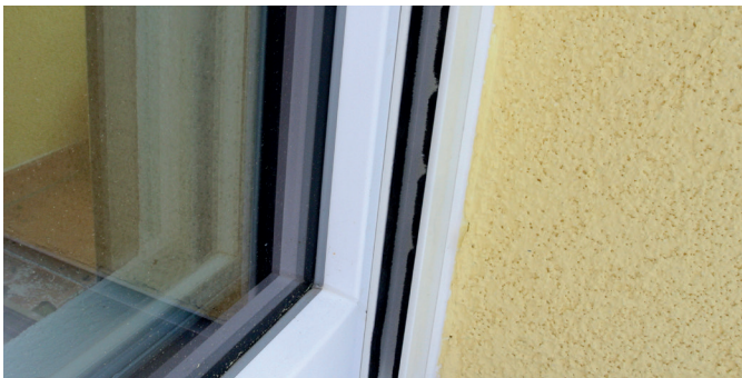
Abbildung 24: Der Keder ist teilweise so stark eingedrückt, dass er sich nicht mehr in seine ursprüngliche Form zurückstellt.
