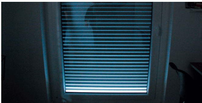
Abbildung 14: Indirekter Lichteintrag über die Fensterbank. Hier sitzt der Rollladenpanzer auf den Endkappen der Führungsschienen auf. Diese Ausführung wurde im Vorfeld vertraglich vereinbart.
