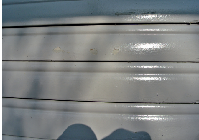
Abbildung 13: Fehlstellen in der Lackierung eines Holzrolllades.
